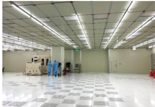
無塵室系統工程 Clean Room System
