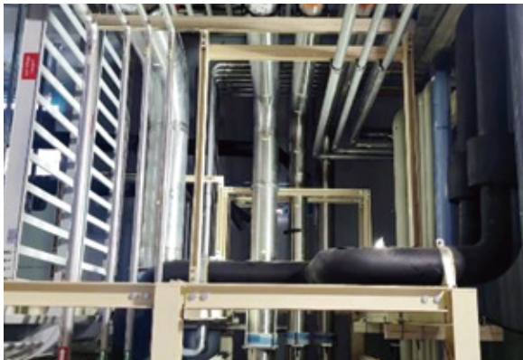
大宗氣體系統工程 Bulk Gas System
