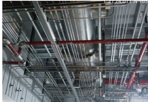
特殊氣體系統工程 Specialty Gas Supply System
