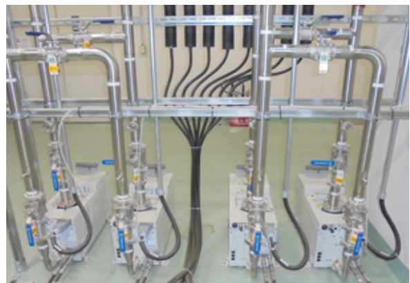
真空排氣系統工程 Vacuum Piping System
