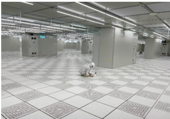
無塵室系統工程 Clean Room System
