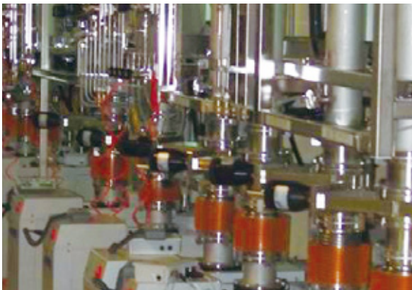
真空排氣系統工程 Vacuum Piping System
